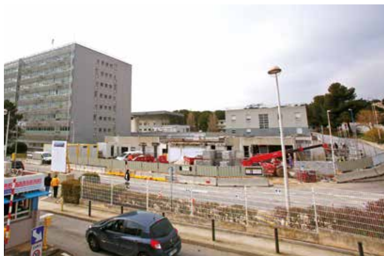
Le chantier de construction du centre de dialyse sera terminé à la fin de l'année.
